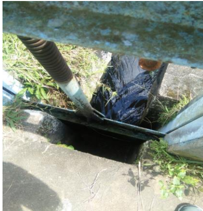
Gambar 2.5 Pintu saluran bagi sadap
