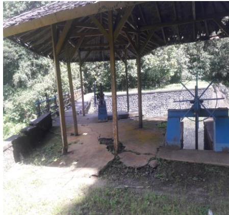
Gambar 2.2 Kondisi fisik Bendung Dam Cai
