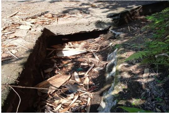
Gambar 1. 3 Kondisi saluran dgorong-gorong pada salah satu ruas jalan di Desa Adat Sibanggede, Kecamatan Abiansemal Kabupaten Badung
