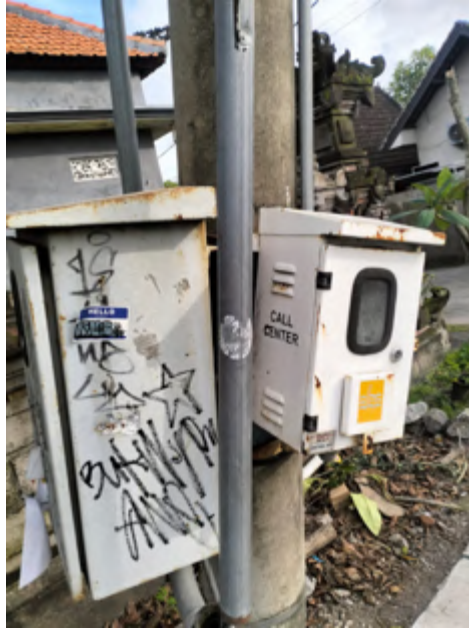
Gambar 6. Gambar Panel listrik PJU (Sumber: Hasil Dokumentasi 2025)
